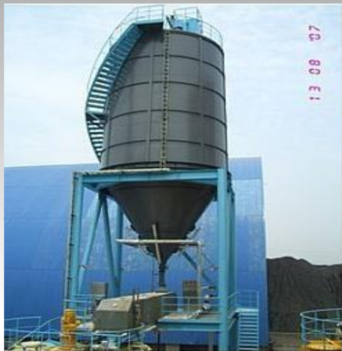
脱硫剂制备系统—石灰石粉仓
