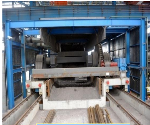
渣罐倾翻装置
