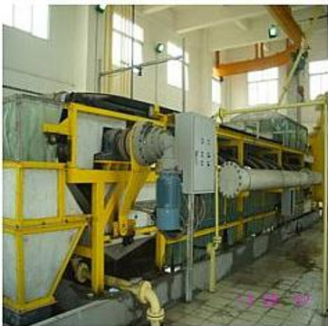
石膏脱水系统—真空皮带机
