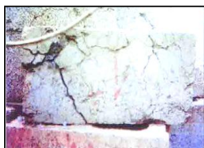
建材制品开裂
