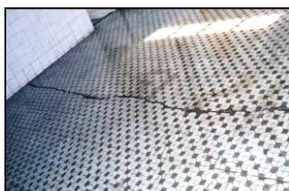
建筑物地面开裂
