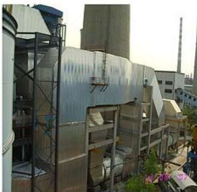
烟气系统—增压风机及烟道
