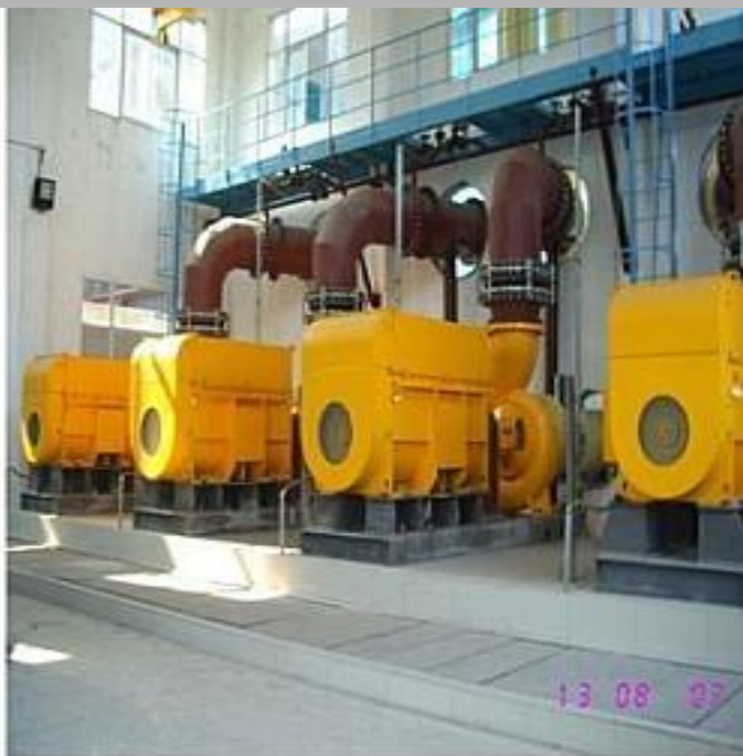
吸收系统—浆液循环泵
