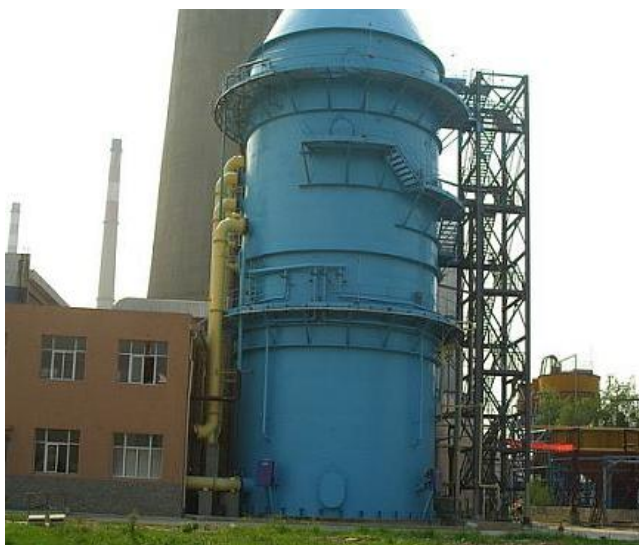
本项目吸收塔
