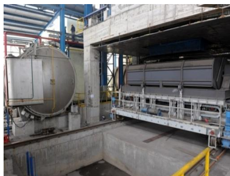
珠海工程-热闷卸料区
