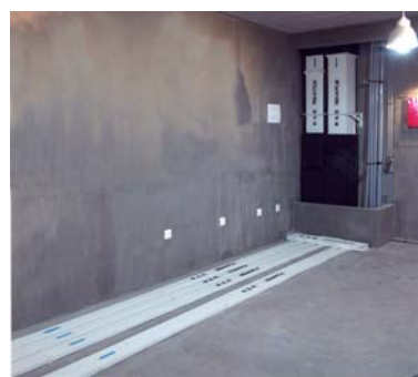
图 15 新风竖井及新风管路
