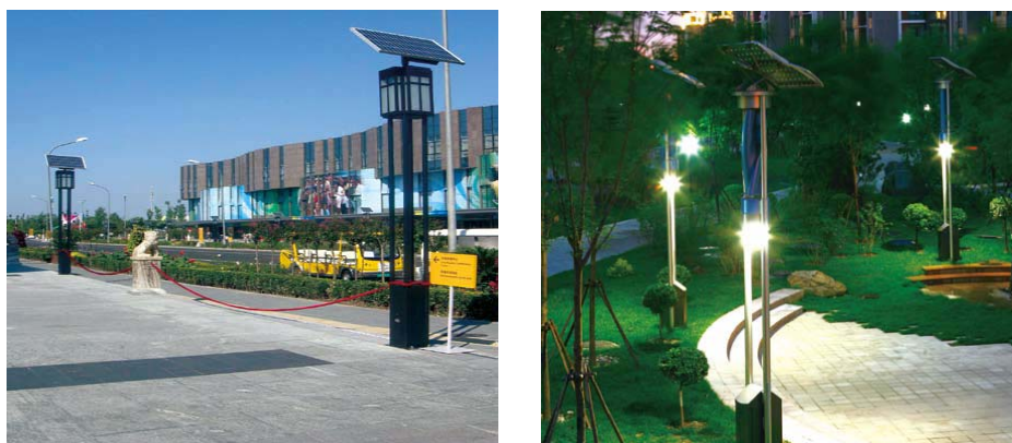
图 9 太阳能路灯照明
