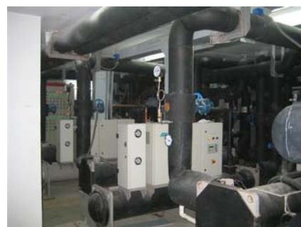
图 23 地源热泵机组
